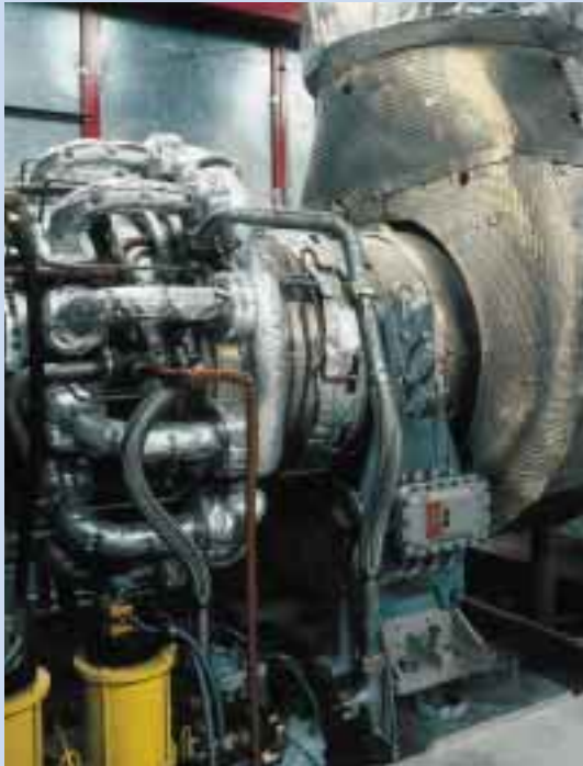
Das Kraftwerk im Haus spart den Ökosteuerberater
